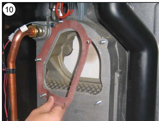
Sprawdzić uszczelkę pokrywę palnika pod kątem jej ew. uszkodzenia, w razie potrzeby wymienić
